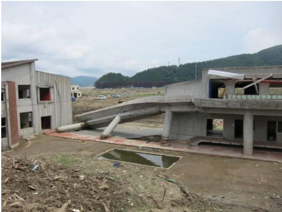
Passage collapsed due to tsunami.
